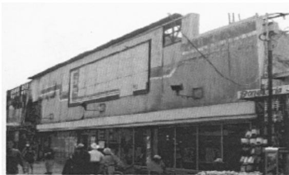
Fotografía 37: Condiciones en deterioro de los edificios de la zona Comercio y Abastos.
